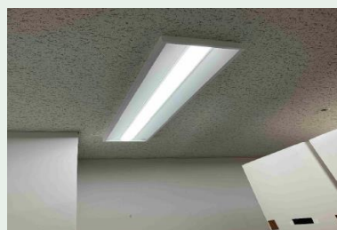
▼中央区役所等の照明 (整備後)
