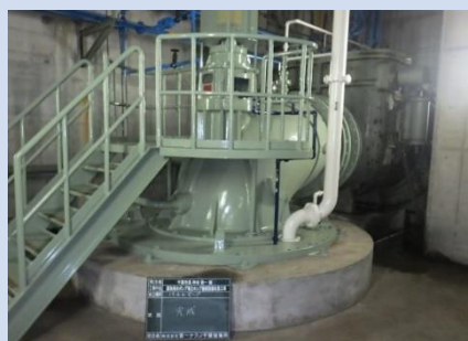
ポンプ場整備事業
