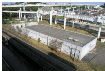
殿台変電所設備
