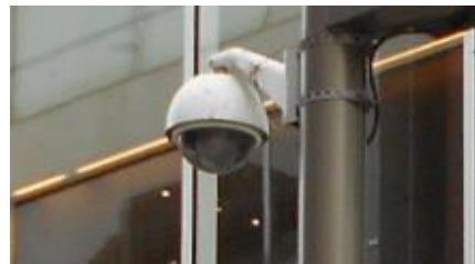
(防犯カメラ設置例)
