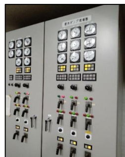
(平川浄水場 電気設備)
