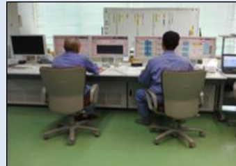
(中央浄化センター：中央監視室)
