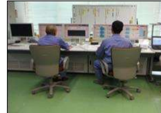
中央浄化センター：中央監視室
