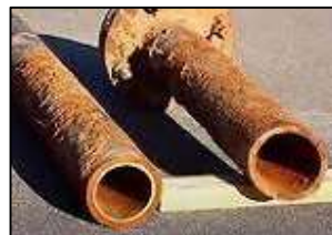
<水道管路 老朽化>
