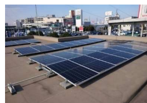
(市公共施設に設置している太陽光パネル)
