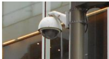
(防犯カメラ設置例)
