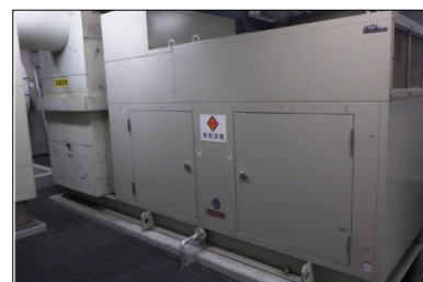
(非常用発電設備のイメージ)
