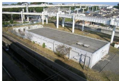
殿台変電所設備
