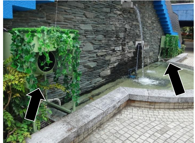
屋外空調機器
